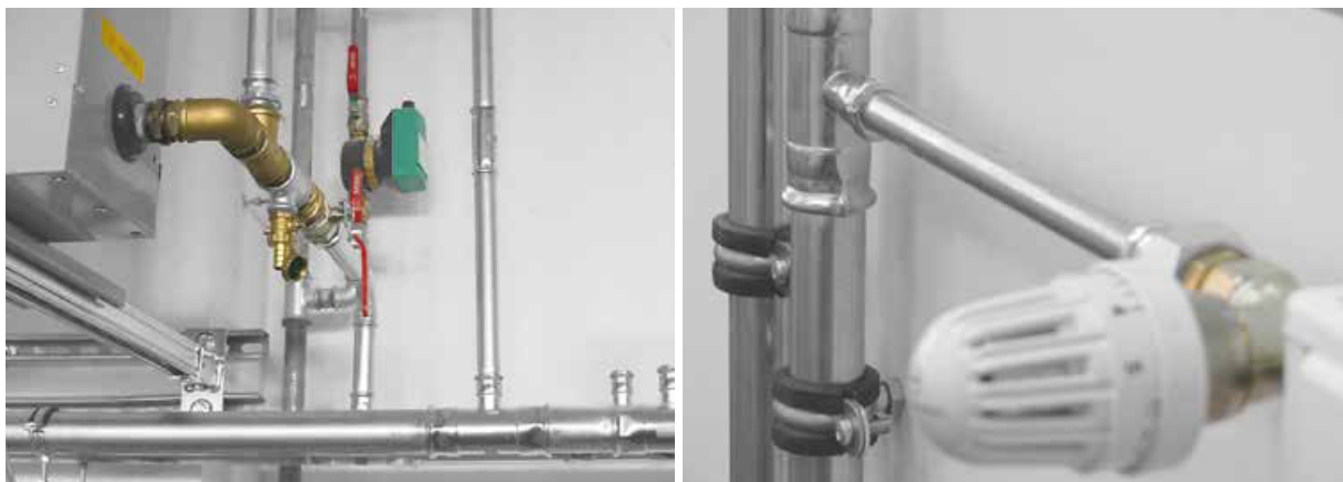
Przykłady instalacji KAN-therm Steel
